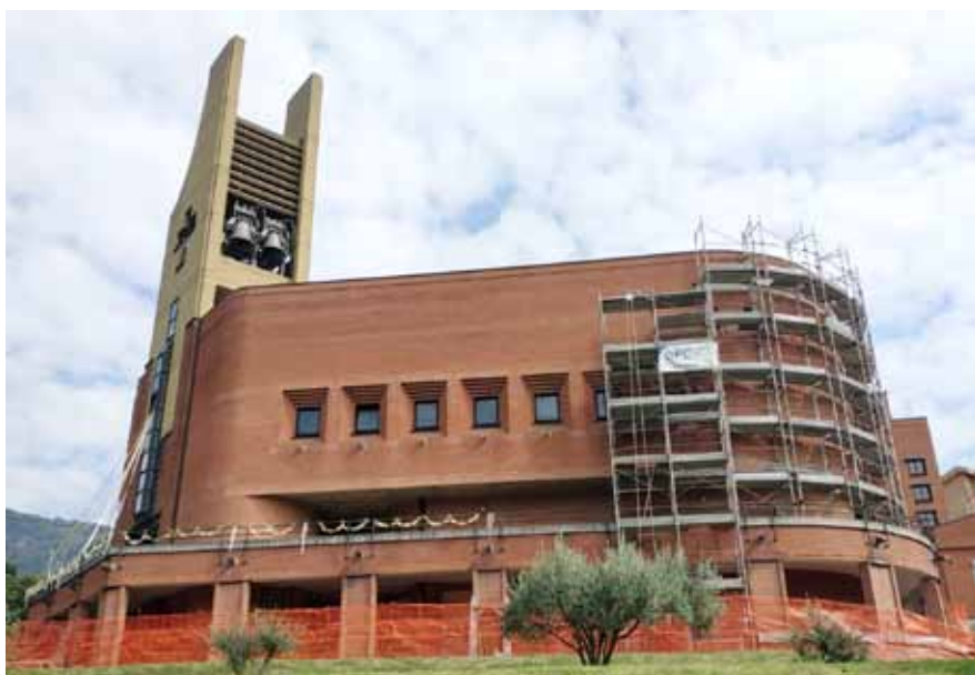
Foto attuale della chiesa nuova con lavori di riqualificazione in corso a settembre 2024. A dx, le infiltrazioni che hanno provocato il danno.
